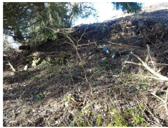
Mit Müll durchsetzter südliche Schotterböschung.
