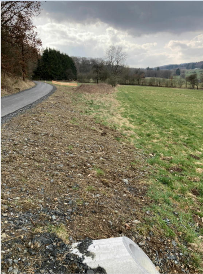
Bild Nr.3: Blick nach Westen, im Hintergrund alter Apfelbaum. Davor im Gestrüpp beginnt bereits die ehemalige Grabenmulde Bis dahin muss eine neue Grabenmulde hergestellt werden.
