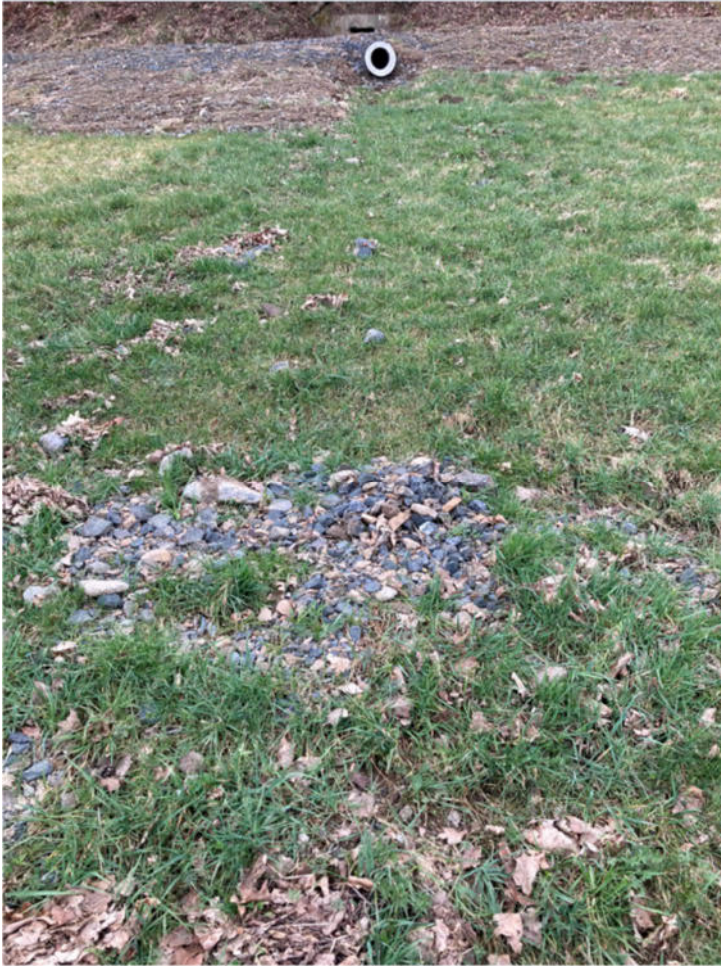
Bild Nr.2: Erhebliche Geschiebemengen unterhalb des neuen Durchlasses Nach Bau des RRB Nord wird sich diese Wassermenge deutlich verringern Drosselabfluss ca. max. 30 l/s
