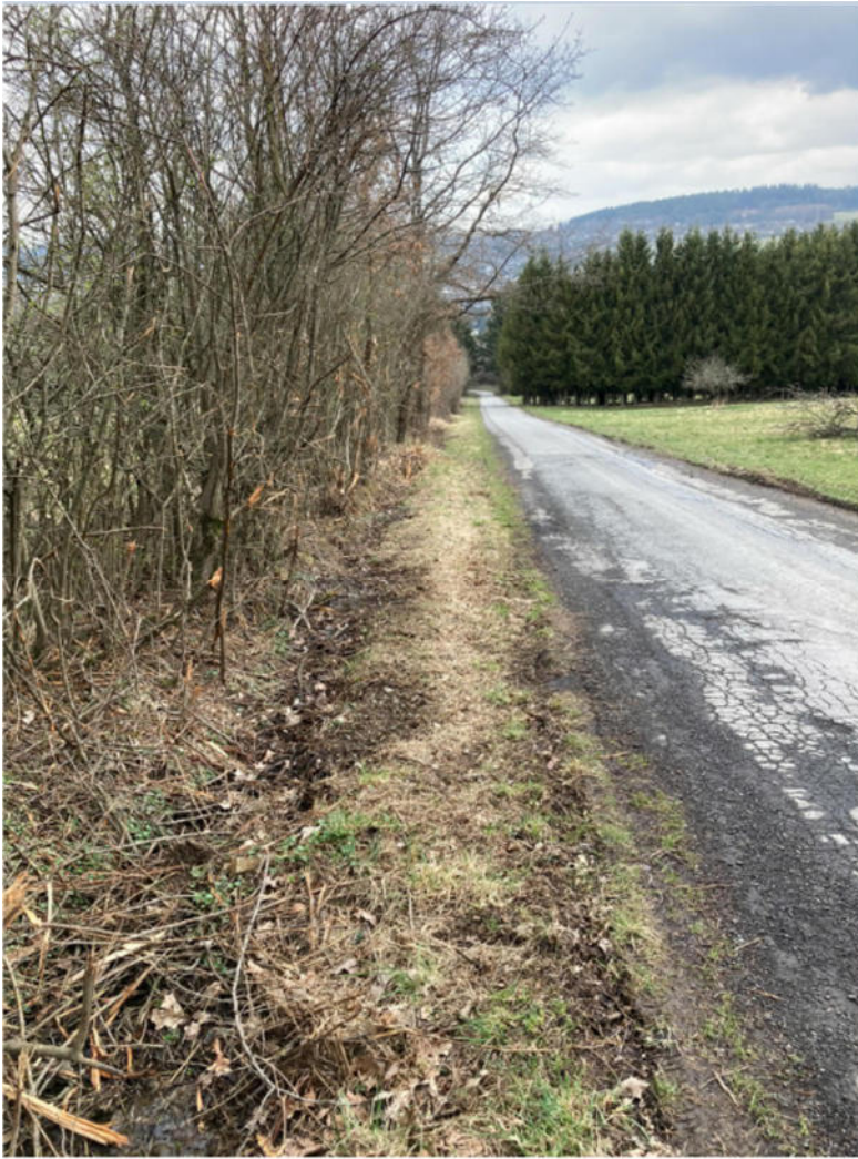
Bild Nr.5: vorh. Wegseitengraben entlang Wirtschaftsweg in Richtung Allendorf. Der Graben ist stark verwurzelt und weist eine Vielzahl von alten Rohrdurchlässen auf, welches ebenfalls stark verlandet sind. Ob diese Zufahrten noch gebraucht werden, entzieht sich unserer Kenntnis. Dieser Grabenabschnitt sollte nachprofiliert werden. Aufgrund der starken Verwurzelung könnte hier eine Fräse sehr nützlich sein.
