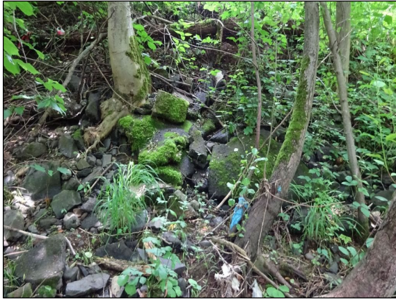
Abb. 10 Überreste einer Ufersicherung aus Steinblöcken und gegossenem Beton.
